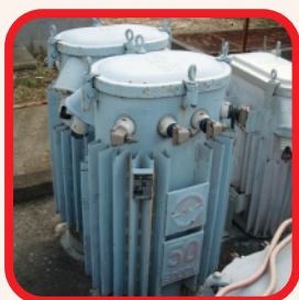
トランス (変圧器)
